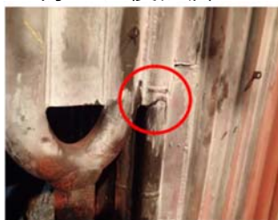
1号機：ボイラー管損傷状況
