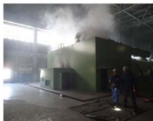
4号機：タービン出火状況
