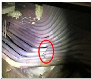
2号機：ボイラー管損傷状況①
