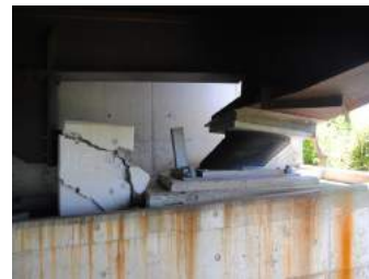
支承残留変位及び移動制限ブロックの損傷
