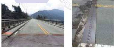
A2側と比較して損傷は軽微
