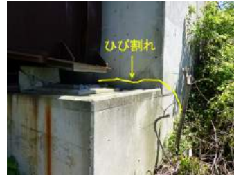
パラペットの損傷
