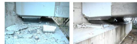
(d) Failure of attachments of rubber bearings
