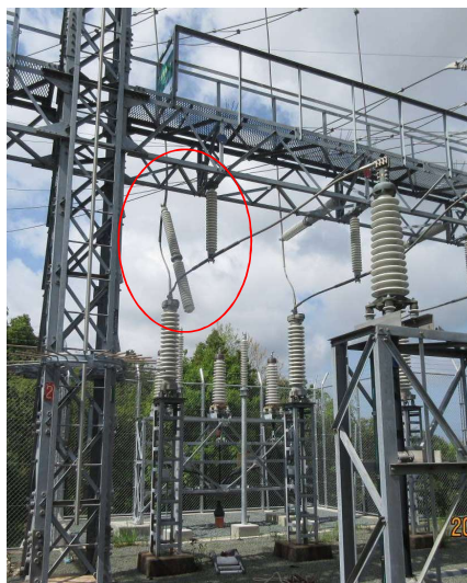
66kV 熊本大津線 1 号線 No.2-7
