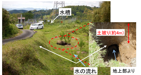
導水路トンネルアーチ部一部崩落
