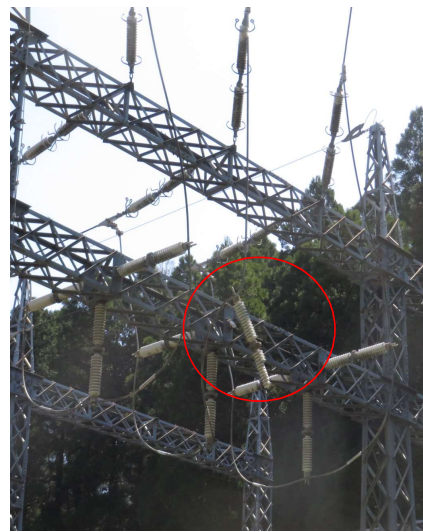
110kV 八丁原松原線 No.37
