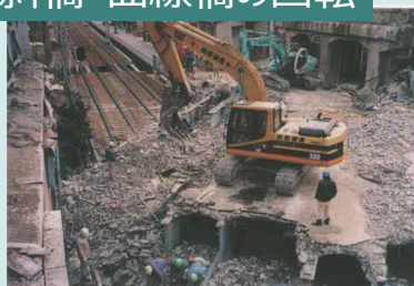
1995年兵庫県南部地震 | 門戸高架橋
