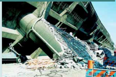
1995年兵庫県南部地震 | 東灘区深江本町
