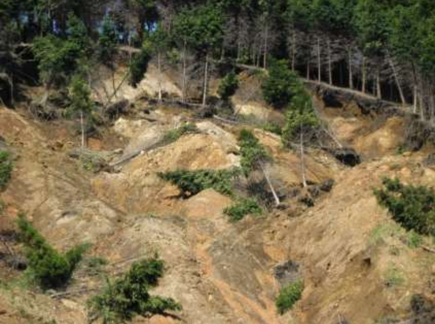
写真3.1-13 ①崩壊頭部
