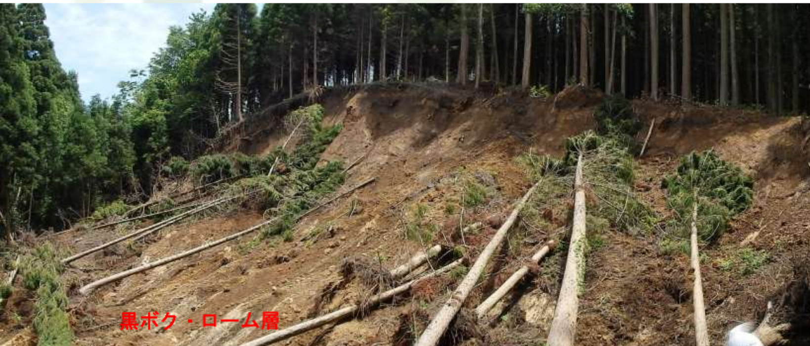
写真3.1-22 斜面上部の表層崩壊状況(上の写真3.1-21の左側崩壊の頭部)
