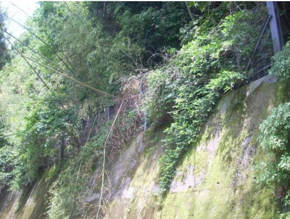
写真3.1-30 落石による防護ネットの破損（破損はしたものの落石そのものは防護できている）
