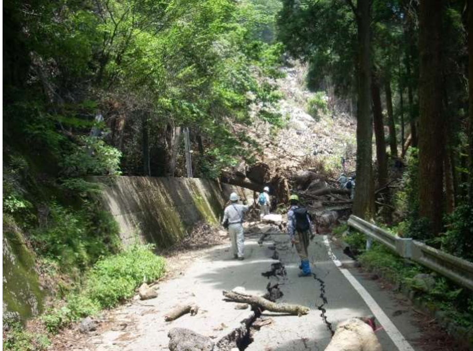
写真3.1-31 舗装道路の破損
