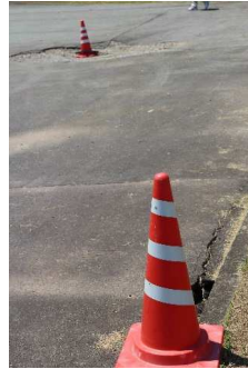
敷地内液状化
