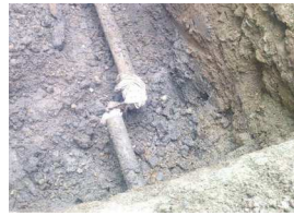
低圧ねじ接合鋼管の破断
