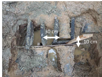
断層横断部のK形継手ダクタイル鉄管の抜け(Φ150, Φ200, 益城町平田)
