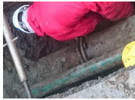
中圧Bガス導管の継手緩み
