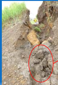
崩壊底部の横断クラック
