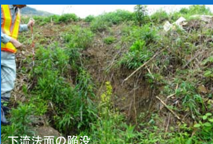
下流法面の陥没
