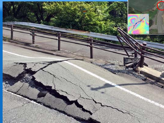
断層通過部 (道路柵の折れ曲がり)
