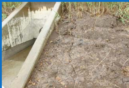
水路近傍にはクラックが集中
