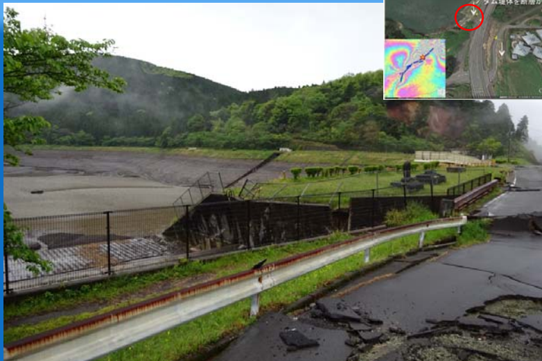
洪水吐壁の破損
