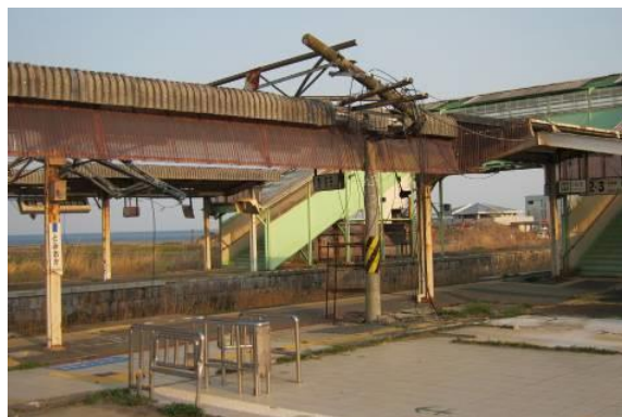
写真⑨ 地震・津波被害を受けた富岡駅。発災後 3 年経った今も復旧されていない。
