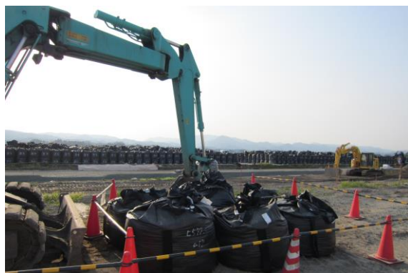
写真⑦ 楡葉町の除染廃棄物仮置き場。大量の土のうが野積みになっていた。
