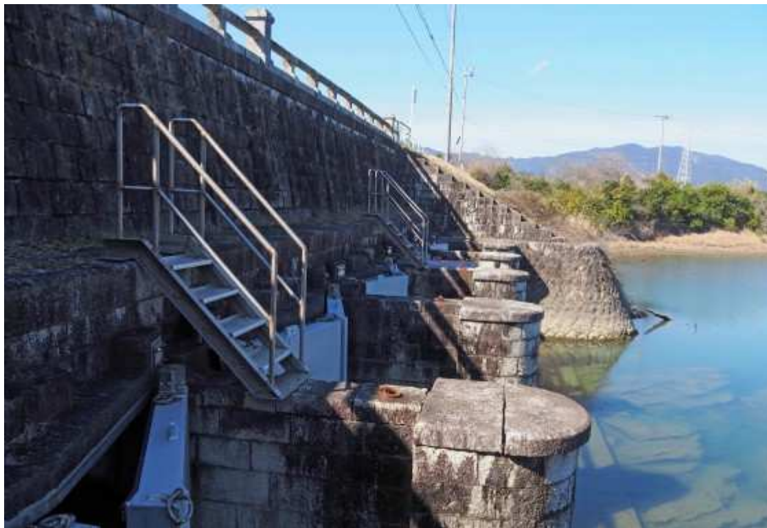
緑橋防潮水門
