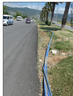
断層を跨ぐ区間の埋設管路の座屈
