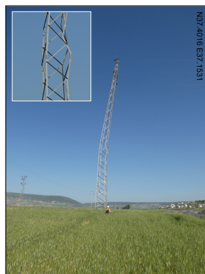
断層を跨ぐ区間の送電鉄塔の部材の座屈
