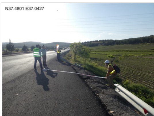
断層変位を受けて高速道路の盛土区間に生じた横ずれ
