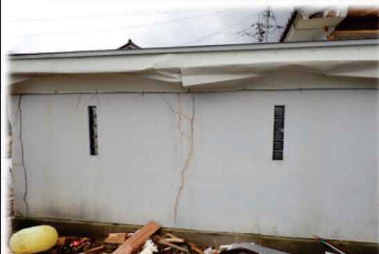
受圧面の損傷状況（ひび割れが見られる）
