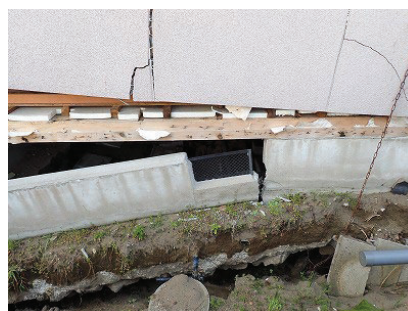
液状化・側方流動に弱い家屋
