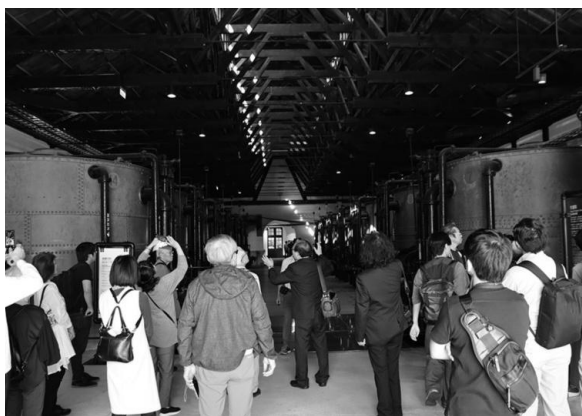
写真3 台南水道の急速濾過装置室
