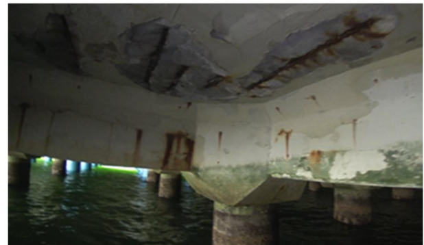
図-7 コンクリート剥離状況（塩害）
