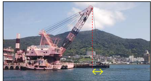
図-1 海中でのグラブバケットの流動による掘削箇所のズレ
