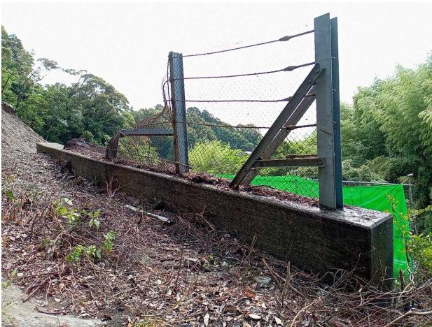
写真-2 崩土によるストンガード損壊状況
