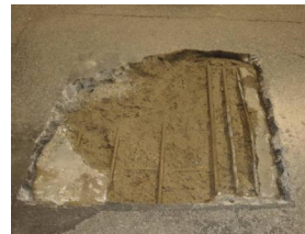
床版コンクリートの塩害、凍害、ASR及び交通荷重による疲労の複合劣化？
