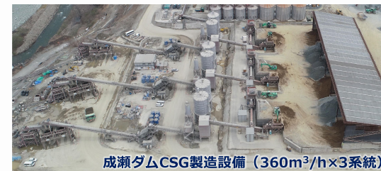
成瀬ダムCSG製造設備 (360m 3 /h×3系統)
