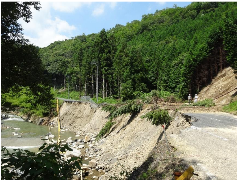
【河川沿いの道路崩落】
