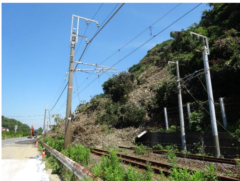
【JR 山陽本線斜面崩壊】
