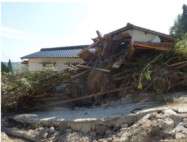
【瀬越地区土石流 2 家屋被害状況】
