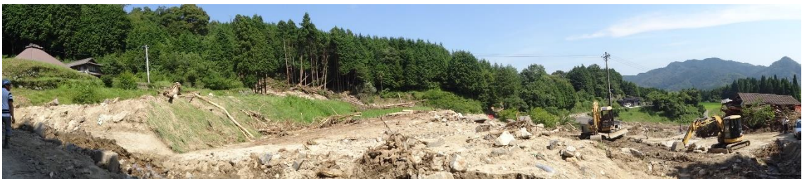
【瀬越地区土石流 2 堆積部】
