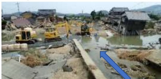
末政川0.7km付近の両岸決壊箇所
