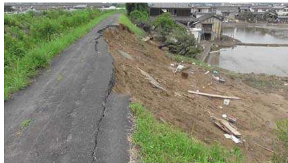
写真1 高馬川裏のり部分の崩落
