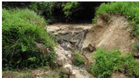
写真2 ため池破堤の状況
