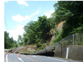
図3-3-1-3 被災地①の状況(起点方) (距離標398K850付近：表層崩壊)
