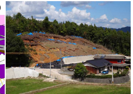
写真3-2-3-3 農道のり面で発生した地すべりの遠景
