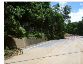
図3-3-1-4 被災地①の状況(終点方) (距離標398K850付近：表層崩壊)
