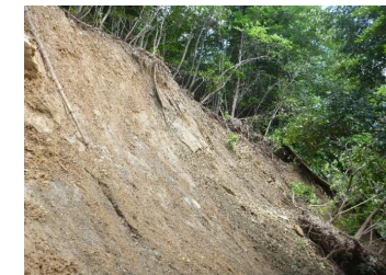
図3-3-1-5 被災地①の状況 22 (距離標398K850付近：表層崩壊)
