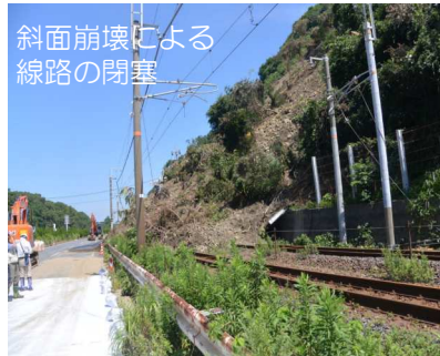
JR 山陽本線の斜面崩壊による線路および側道の土砂閉塞
