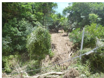
図3-3-1-6 被災地②の状況 (距離標398K900付近：表層崩壊)
