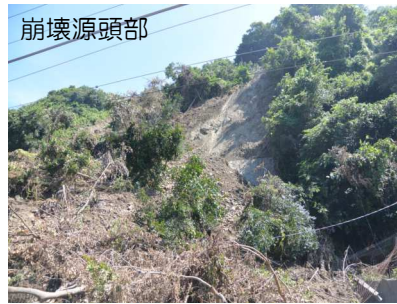
JR 山陽本線の斜面崩壊の崩壊斜面
