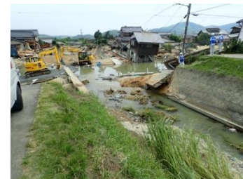
図10 末政川0.7KPの堤防決壊状況
