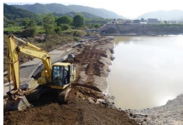
図9 小田川3.4KPの堤防決壊状況
