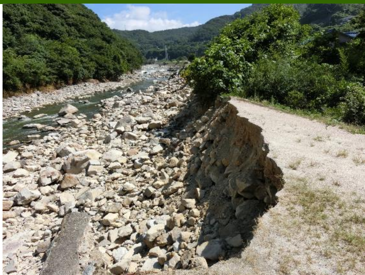
①黒瀬川左岸の護岸が大きく浸食されている
