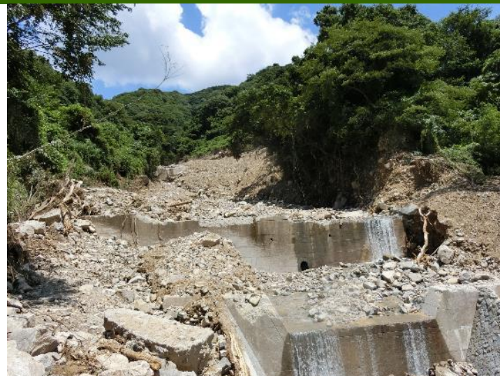
①砂防堰堤も崩壊されている。（7/10撮影）
