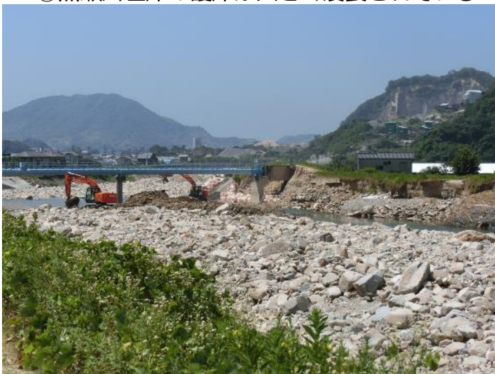
③右岸側にあった水道橋の橋台部分で浸食されていた
