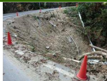
① 土石流が県道66号呉環状線を横断して流下
