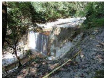
⑰2段の砂防堰堤下流側。満砂状態 8/5撮影
