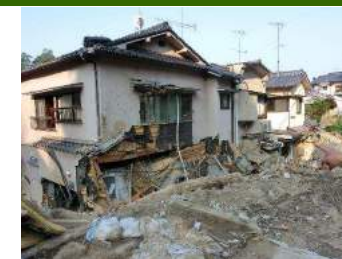
⑦家の一階部分が大きく損壊している。
