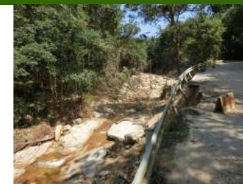
⑱左岸が流下した土石流の影響もあり、道路陥没
