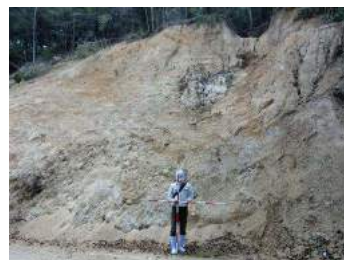
③ 深山の滝入口から約70m焼山側のがけ崩れ。 8/5撮影
