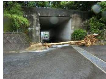
③側道に流下した土石流はボックスカルバートを通って下流の住宅街に流れ込んだ（7/8撮影）
