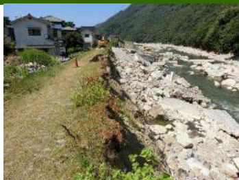
②少し下流側の左岸も浸食されていた。
