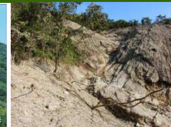
②湾曲部分の様子。大量の水を含む土砂が流下したと思われる
