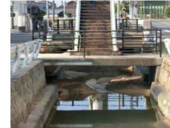
⑨下流では河川内に多量の土砂が堆積していたと思われる。（国道31号付近）
