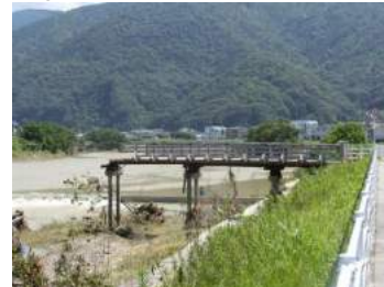
木製の真光寺橋が流された (7/10撮影)
