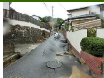
③団地内の道路を河川水が流下した（7/8撮影）
