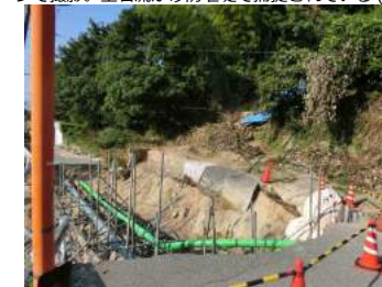
⑤右岸から来たがけ崩れの土砂で堰き止められ、左折。それによりり面が削られ、道路が陥没。（8/4撮影）
