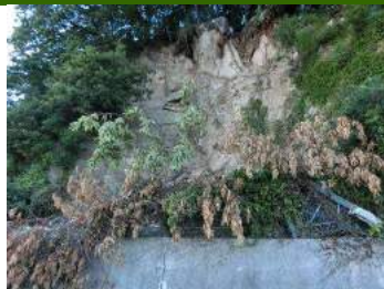
②岩盤崩落によりオーバーハングしている
