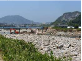
③右岸側にあった水道橋の橋台部分が浸食されていた
