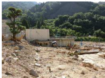
②水源地管理施設も被害を受けている
