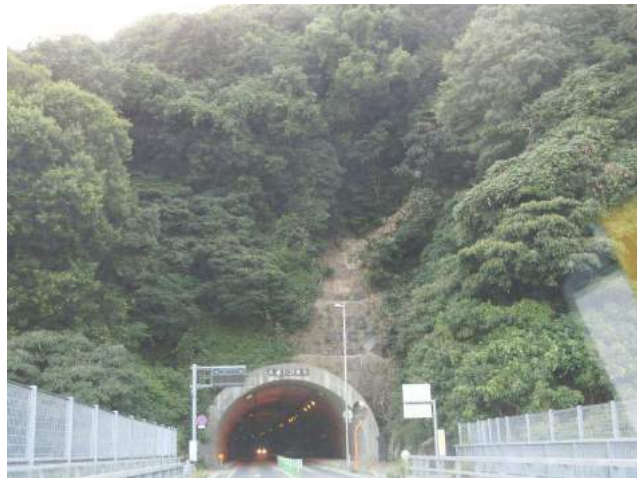
豊橋大橋側トンネル坑口で土砂が流出。
