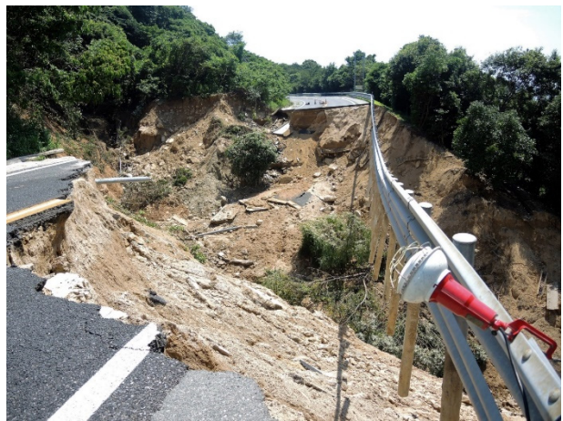
図 3-4-4 広島呉道路における盛土の崩壊
