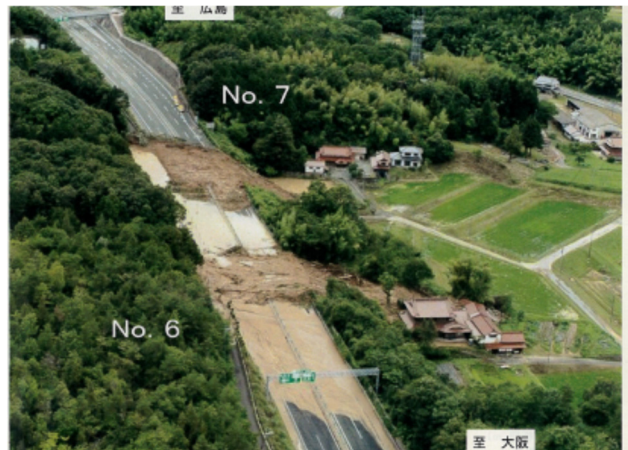
図 3-4-3 山陽自動車道高屋-河内間の土石流災害
