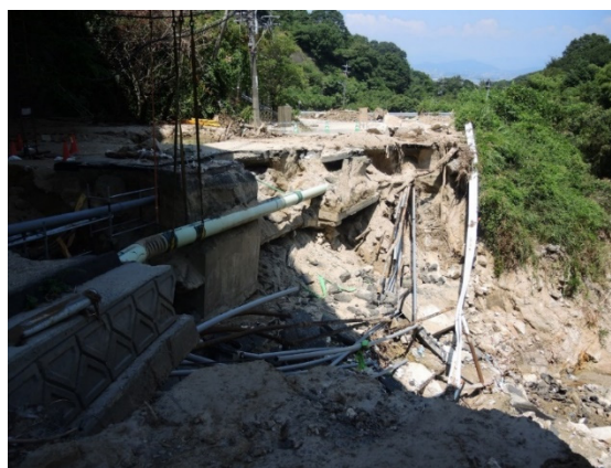
図 3-4-6 県道 34 号線矢野の陥没 (路面上を高さ 3~4m の土石流が横断)
