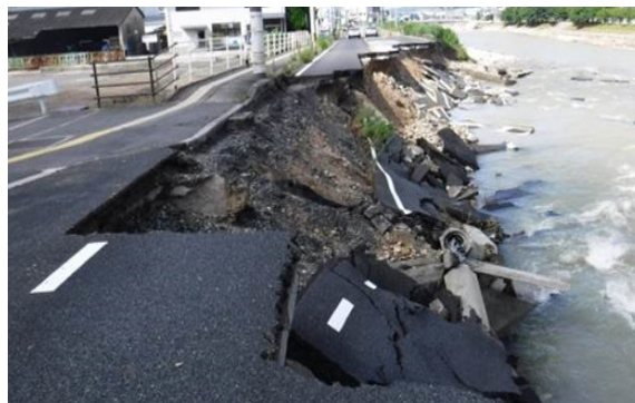
図 3-4-5 国道 2 号線 瀬野川河岸の陥没 (写真: 中国地方整備局)
