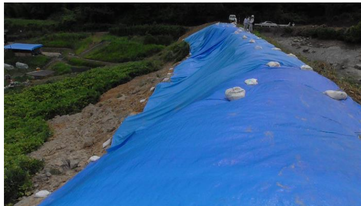
崩落した裏法面
