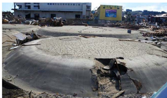
写真 2.2-3 津波によりむき出しになったタンク基礎（2011 年東北地方太平洋沖地震） 8)
