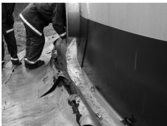
写真 2.2-4 液状化によるタンクの沈下・基礎の変形（2011 年東北地方太平洋沖地震） 7)
