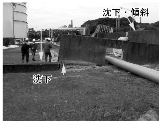
写真 2.2-5 液状化による防油堤の沈下・傾斜（2011 年東北地方太平洋沖地震） 7)
