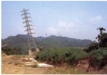
写真 2-2 鉄塔基礎の被害 1)
