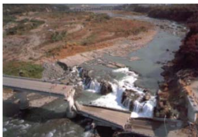
写真 2-4 Bei-Fung 橋の崩壊 1)
