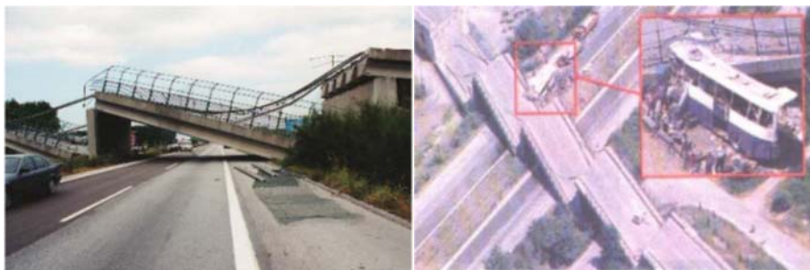
写真2-6 Arifiye 橋の被害状況 2)
