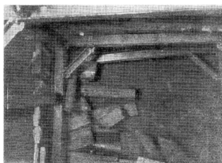
写真2-8 水抜き坑切羽に出現した断層鏡面 2)
