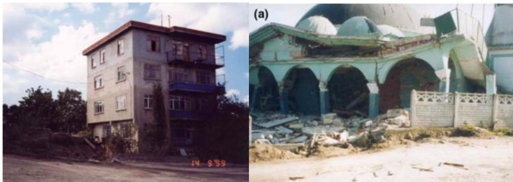
写真2-5 コジャエリ地震による建物の被害状況（左：剛基礎支持，右：柔基礎支持） 1)
