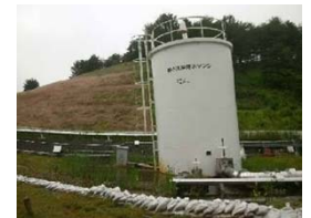
図-2.4.9 5号機碍子洗浄水タンク基礎の不等沈下の状況
