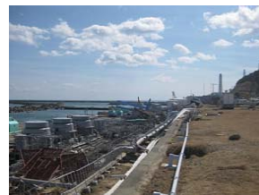
図-2.4.20 ブロック積の法面背面で発生した吸い出しの状況(6号機海側)
