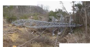
図-2.4.7 盛土の崩壊により倒壊した夜ノ森線No.27鉄塔の状況
