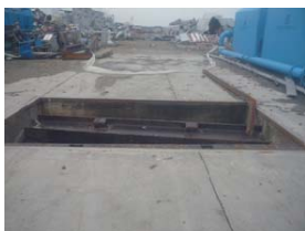
図-2.4.19 取水路角差し口の蓋流出箇所の状況(被災時)
