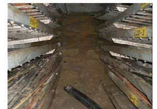
図-2.4.22 5号機屋外トレンチ内へ土砂が流入・堆積した状況
