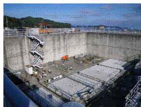
図-2.1.13 2号機海水ポンプ室(除塵機エリア)
