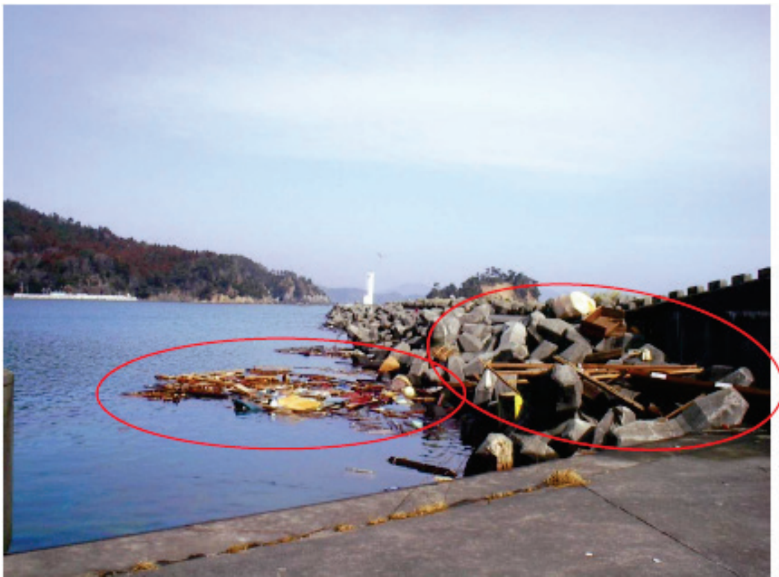
図 8.3.3-32 東防波堤の漂流物状況（平成 23 年 3 月 14 日撮影）
