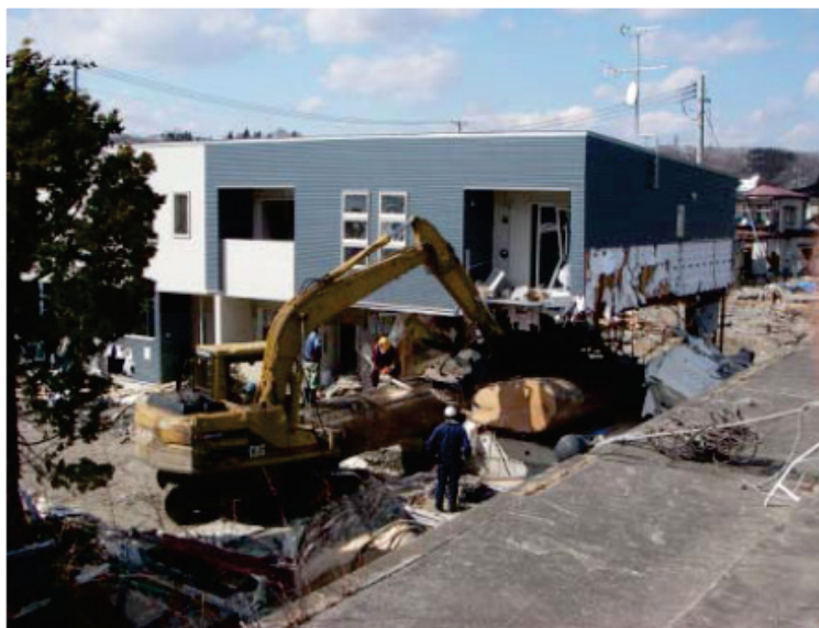
図 8.3.3-7 原木が衝突した建物
