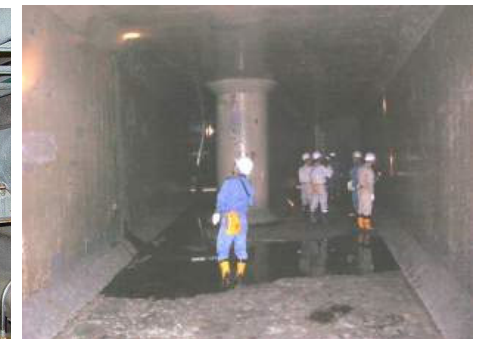
取水路(排水時)
