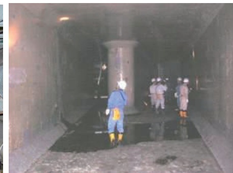
取水路(取水時)
