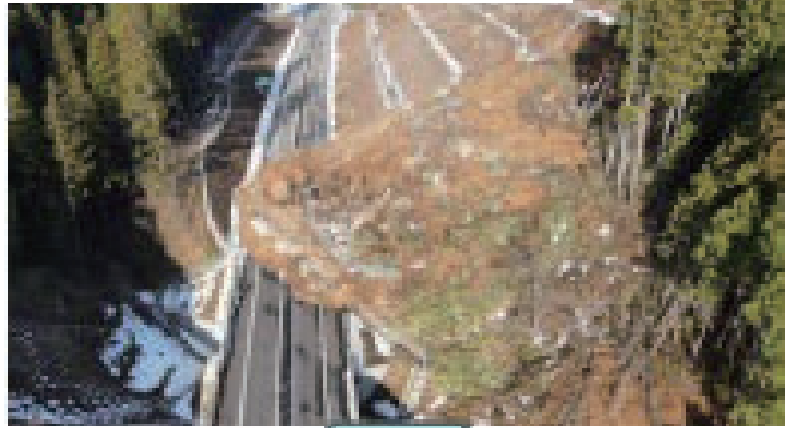
斜面崩壊(地震直後)
