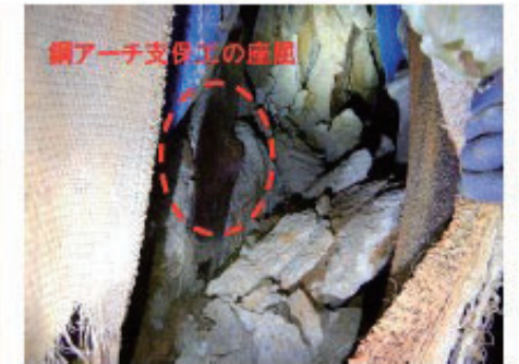
鋼アーチ支保工の座屈
