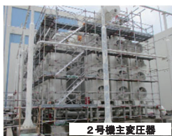
2号機主変圧器
