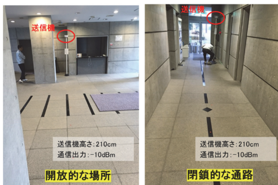
図-4 IMES 送信機の設置状況
