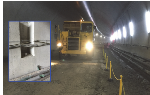
写真-1 実証実験のトンネル坑内と設置したビーコン
