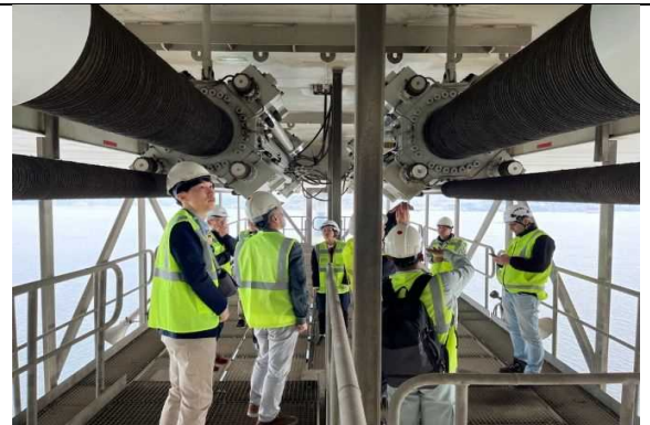
制振装置（油圧バッファー、橋軸方向）
