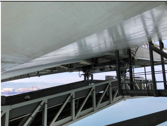
移動式桁下検査足場
