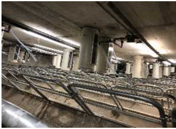
アンカレッジ内チャンバー乾燥（除湿）装置
