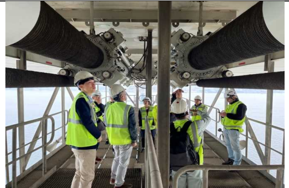
制振装置（油圧バッファー、橋軸方向）
