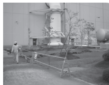
(d) 埋戻土の沈下により生じた不陸 杭支持された地中埋設ダクトの周囲の埋戻土が沈下し、ダクトの境界に不陸が発生
