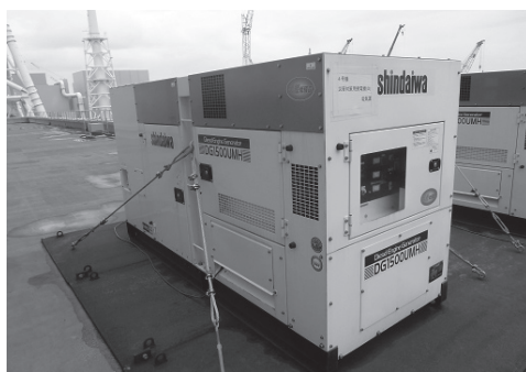
(d) 災害対策用発電機 原子炉建屋の屋上に設置されている
