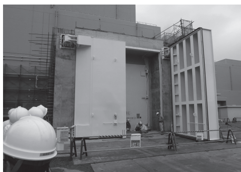
(b) 原子炉建屋大物搬入口の水密扉 十分な水密性・強度を確保するため、2重の防水構造となっている
