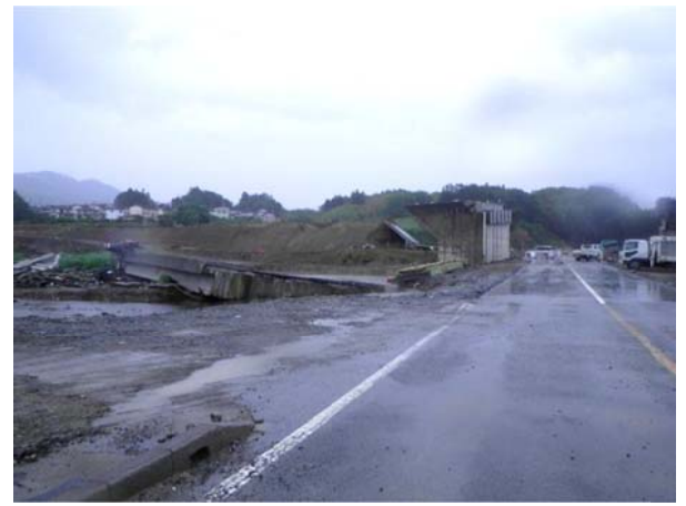
⑦-2 橋台背面盛土および床版の流出状況
