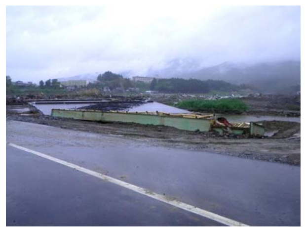
⑦-4 流出した主桁の状況
