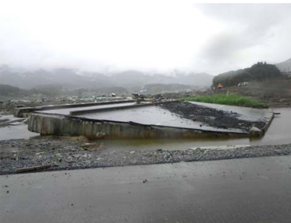
⑦-3 流出した床版の状況
