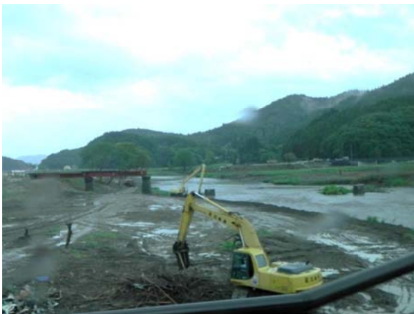
⑩-1 廻館橋下流の鉄道橋の落橋
