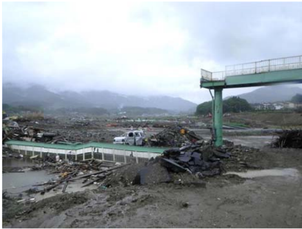
⑥-2 歩道橋の落橋状況
