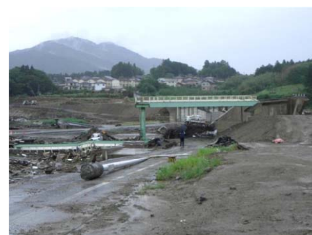
⑥-1 歩道橋の一部倒壊
