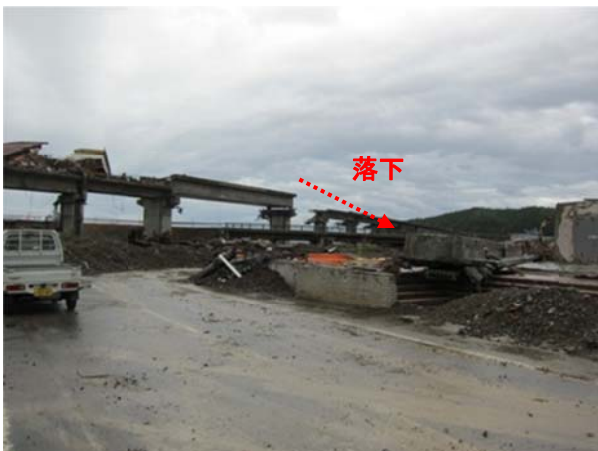
⑤気仙沼線の PCT 桁の落下
