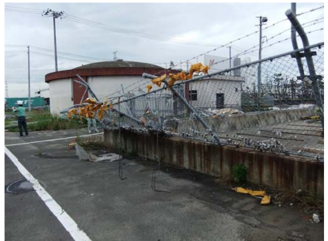
写真-② PCタンクの構造被害は見られない
