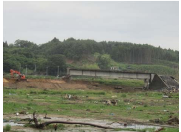
②気仙沼線の高架部と盛土部の寸断
