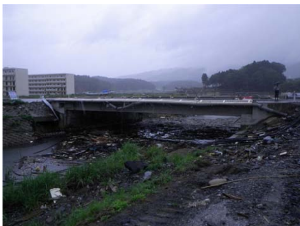
③-1 橋梁高欄の被害（全景）
