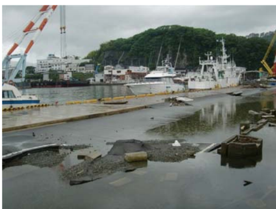
④ 背面が沈下した岸壁
