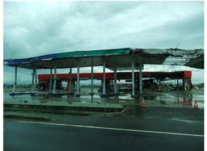
写真-⑧ コスモ石油荒浜SSの被害
