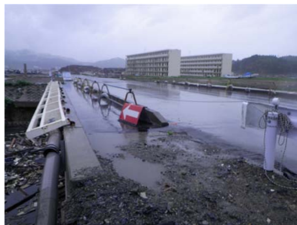
③-2 引波による高欄倒壊
