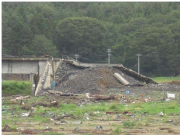
③気仙沼線の盛土部の寸断
