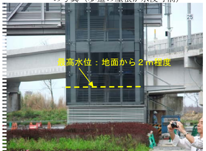
写真-⑥ 階段室側面の津波痕跡
