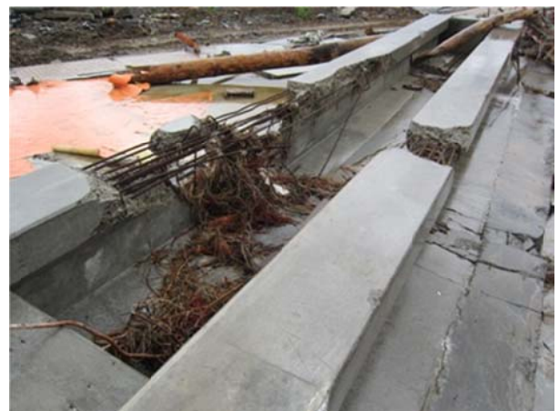
⑨PCT 桁(気仙沼線)の主桁コンクリートの崩壊
