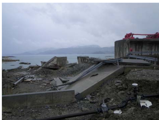
④-1 防波堤の倒壊
