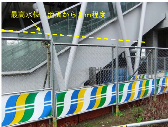
写真-⑤ 階段側面の津波痕跡
