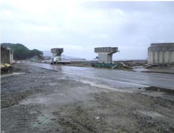
⑦-1 津波による橋梁上部工の落橋
