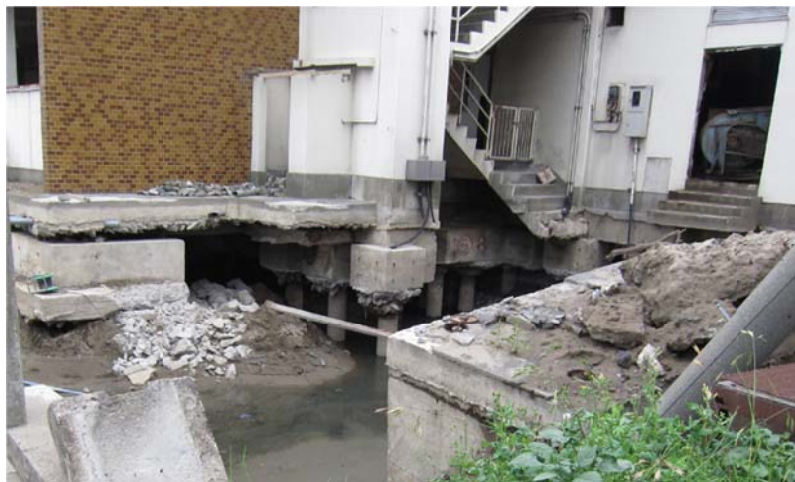
①建物基礎の洗掘
