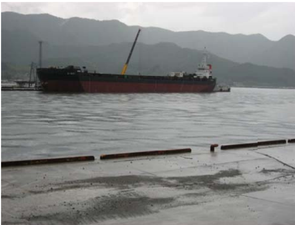
写真-③ 港湾では地盤沈下が発生
