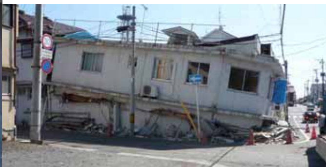
写真-6(1)⑥ 2階建ての店舗 1F の崩壊
