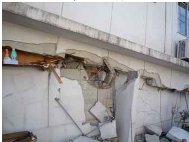
写真-6(2)⑥ 2階建ての店舗 1F の崩壊詳細
