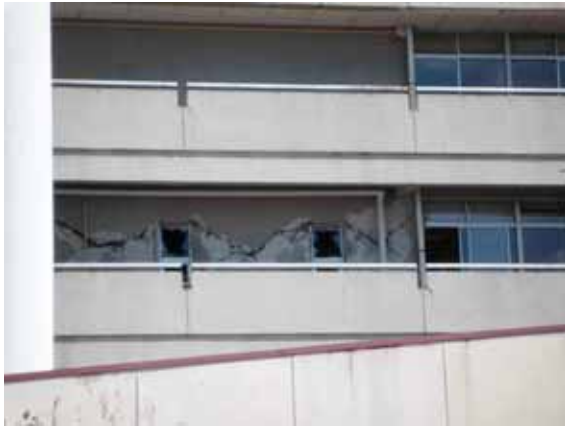
写真-1(3)① 須賀川市役所西側壁
