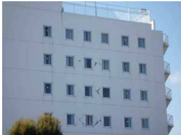
写真-3(2)③ 市役所傍のホテル壁のせん断破壊
