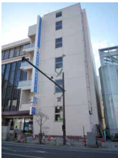
写真-4④ 須賀川市総合福祉センター 西面壁のせん断破壊
