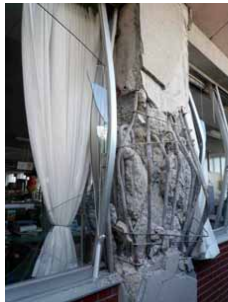
写真-1(2)① 須賀川市役所東側 1F 柱のせん断破壊(主筋は丸鋼)
