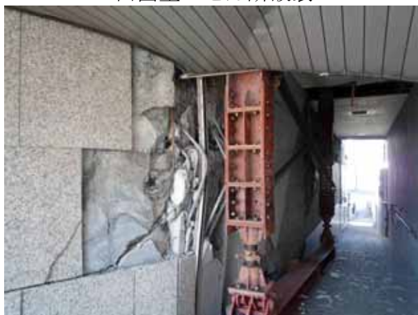
写真-5(2)⑤ 須賀川信用金庫 1F の RC 柱のせん断破壊
