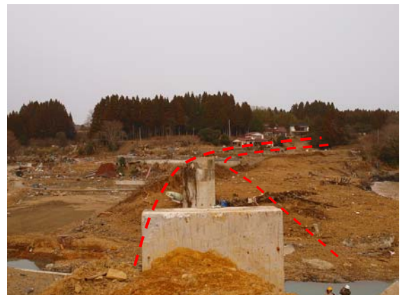
写真-40 愛宕神社付近の鉄道橋の被害 (2)
