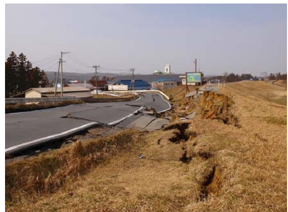
写真-34 志田橋周辺の堤防と道路盛土被害
