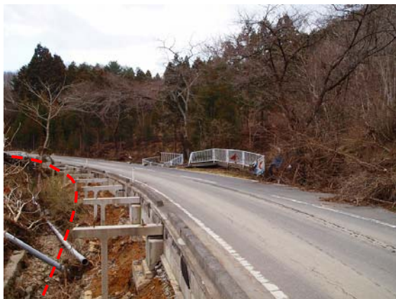
写真-29 被災した歩道構造物（2）
