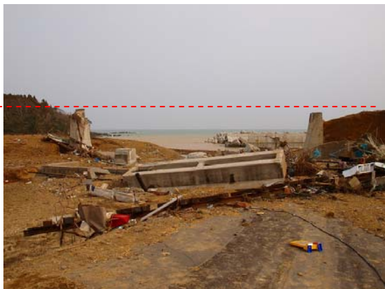
写真-39 愛宕神社付近の鉄道橋の被害 (1)
