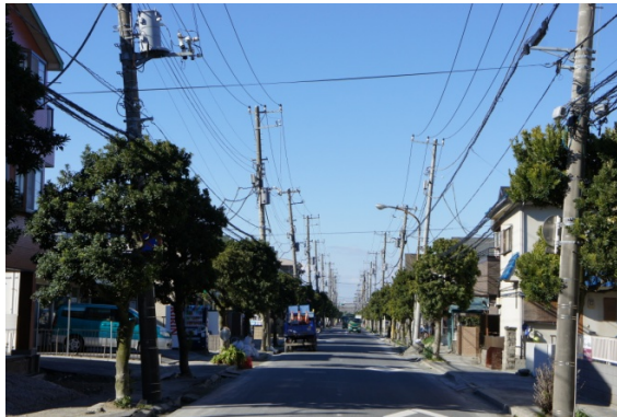
写真5 一様に傾斜した電柱
