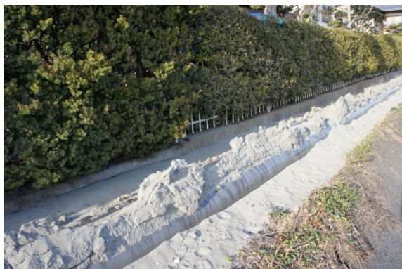
写真 17 浮上した水道管
