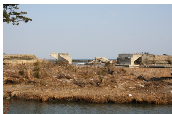
写真 86 橋桁が流出した海岸沿いの道路橋
