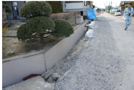
写真 14 噴砂により沈下した民家
