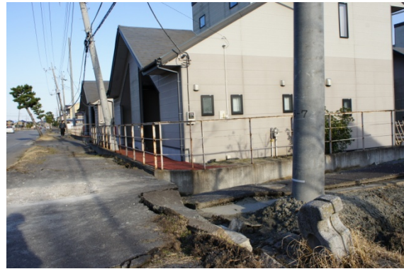
写真 16 街路樹や電柱の傾斜
