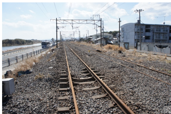
写真 31 津波に洗掘された常磐線のバラスト
