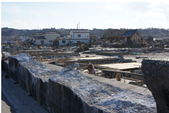
写真 41 津波で破壊された護岸
