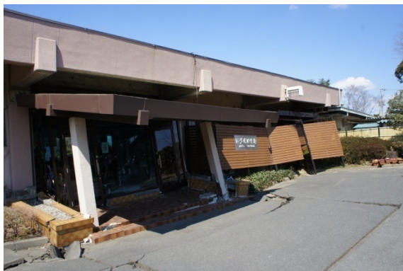
写真 23 大破した阿漕浦倶楽部の建物
