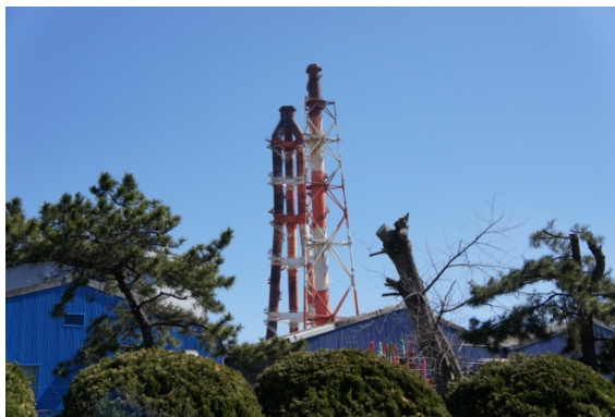
写真7 火災で変色した煙突
