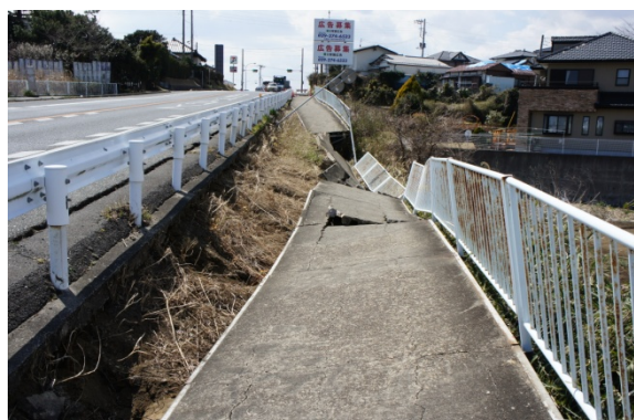
写真 28 245 号線沿いの道路側道被害
