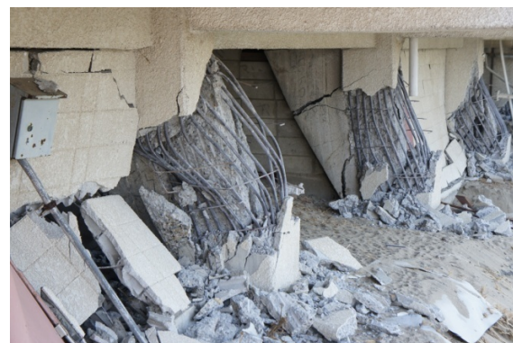
写真 25 建物裏手の柱のせん断破壊部分
