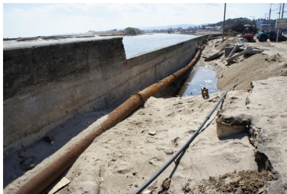
写真 32 洗掘されて現れた護岸裏の地中管路
