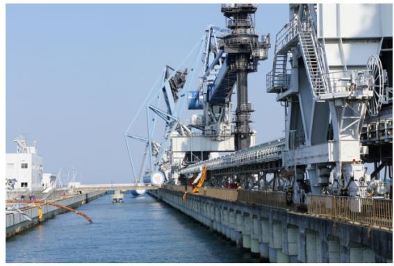
写真 73 水路に落ちかかったカウンターバランス
