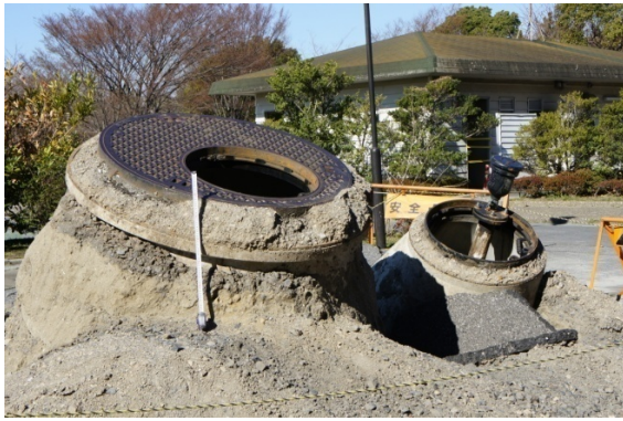
写真3 耐震性貯水槽の浮き上がり
