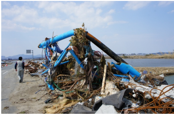
写真 64 破壊された道路橋脇の水管橋（右側が松川浦）
