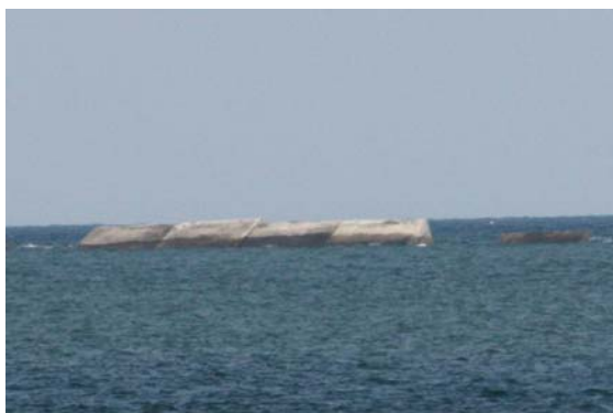
写真 80 被災した防波堤
