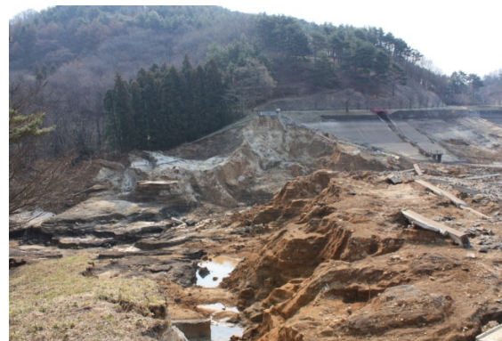
写真 89 ため池決壊箇所（高さ 18.5m の堰堤部分）
