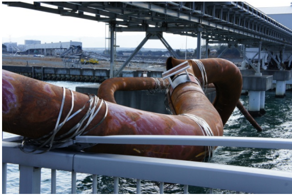
写真 72 コンベアー脇の鉄管被害
