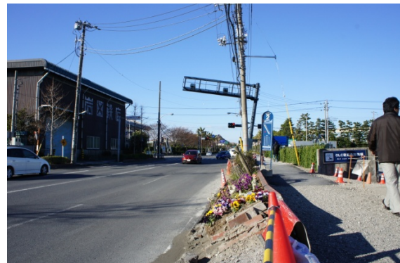
写真 2 道路管理用カメラ鉄柱の傾斜
