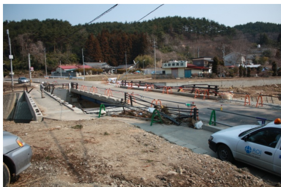
写真 97 泥流は道路橋を乗り越える(左が上流側)
