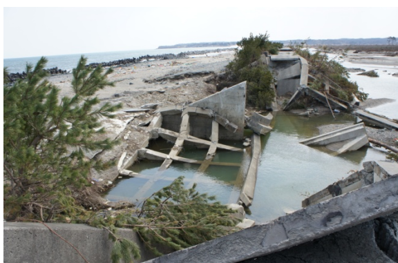
写真 63 破堤箇所の一つ（左側が海）
