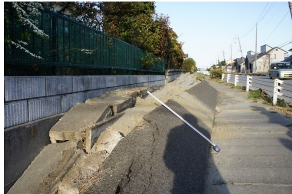
写真 18 アスファルトを持ち上げて浮上
