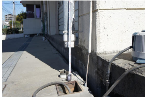
写真4 消防署の被害（車庫前に30cmの段差）
