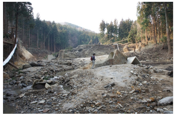
写真 94 流された道路と道路下のボックスカルバート
