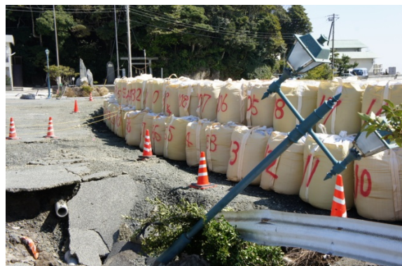
写真 33 土嚢による壊れた護岸の応急復旧
