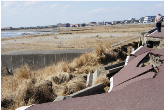
写真 11 津波により壊された護岸
