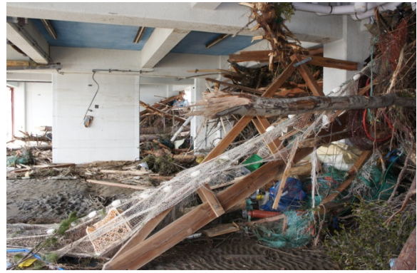
写真 65 松川浦沿いの建物内部（右側が海）
