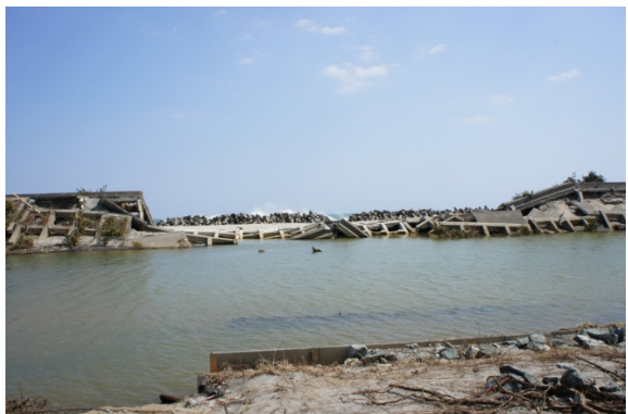
写真 62 破壊された堤防と堤内に残る海水
