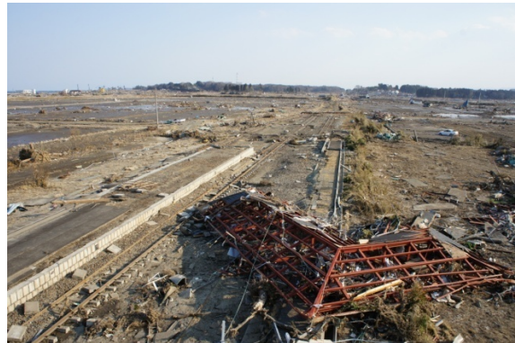
写真 84 鉄骨の骨組みだけが残る駅舎
