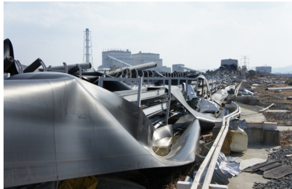
写真 71 石炭運搬用のベルトコンベアーの被害
