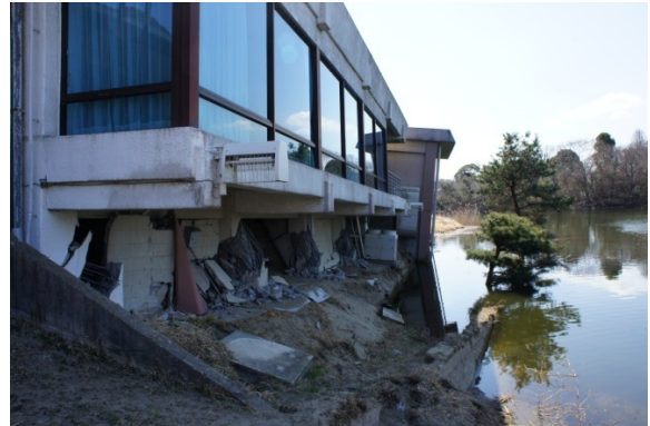
写真 24 建物の裏手：地盤すべりと柱の破壊
