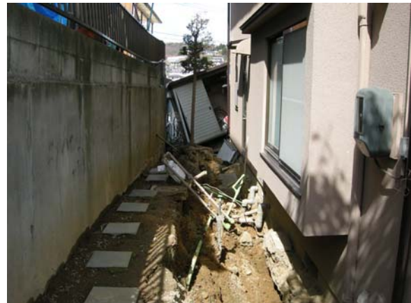
写真-6 緑ヶ丘4丁目の建物基礎部沈下・滑動
