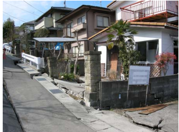
写真-4 緑ヶ丘4丁目の宅地地盤の滑動
