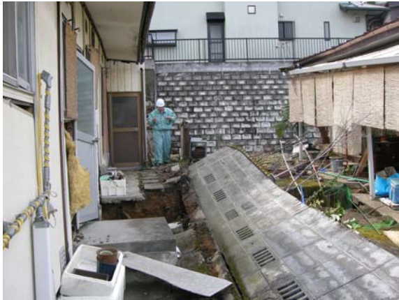
写真-3 緑ヶ丘4丁目の宅地地盤の沈下
