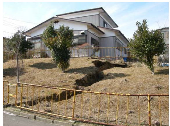
写真-8 緑ヶ丘3丁目の宅地地盤の滑動
