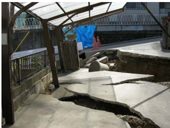
写真-5 緑ヶ丘4丁目の宅地地盤の沈下
