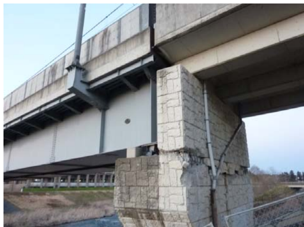
図 1.1 胸壁損傷全景
