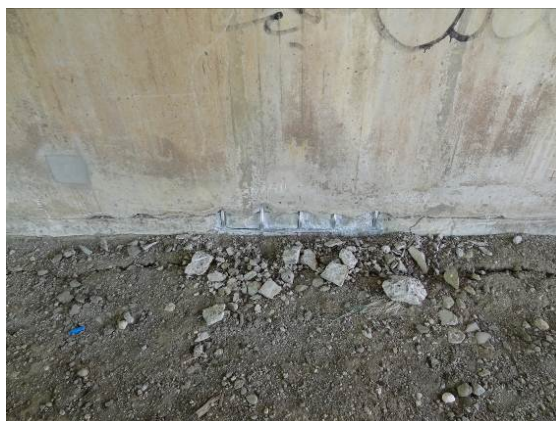
図 4 (図 3 の損傷部の接写)
