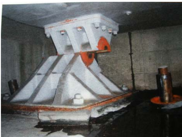
図 2 支承損傷状況（JR 東日本撮影）
