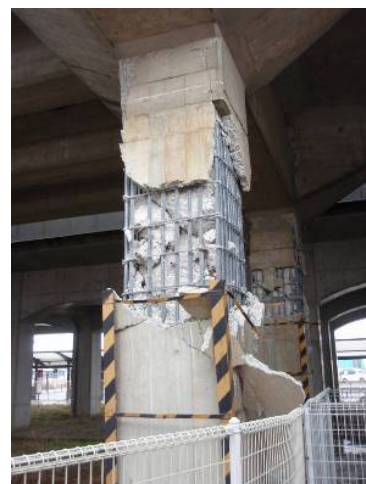
図 1 中長町高架橋損傷状況 (JR 東日本提供)
