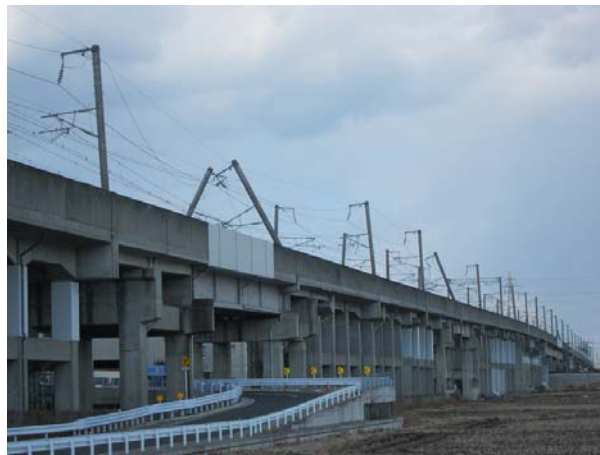
図 1 東北新幹線の電柱の損傷
