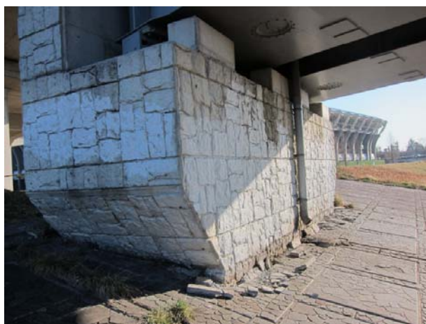
図 3.1 地盤の変状(七北田川橋梁 泉中央川橋台)
