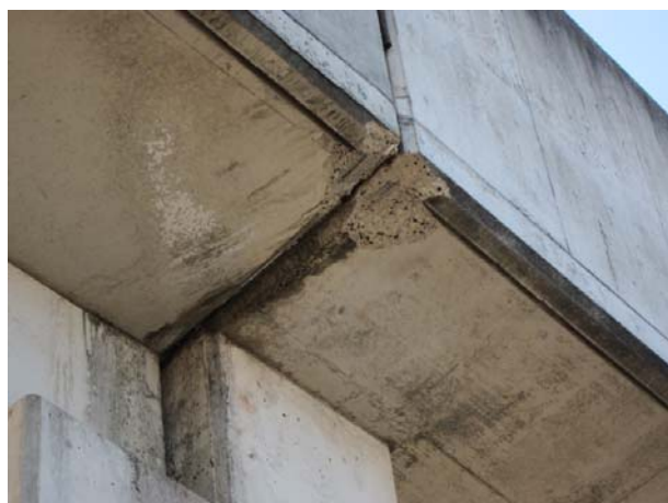
図 1.3 ゲルバー桁損傷
