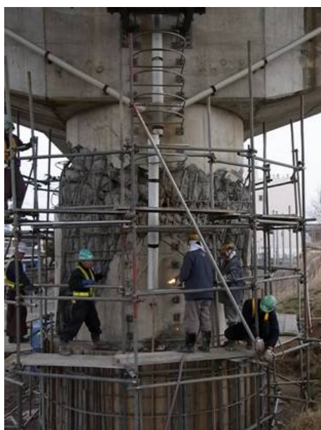
図 1 岩切線路橋 4P 橋脚損傷状況（JR 東日本提供）
