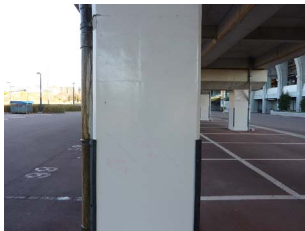
図 4 ラーメン高架橋柱のせん断ひび割れ
