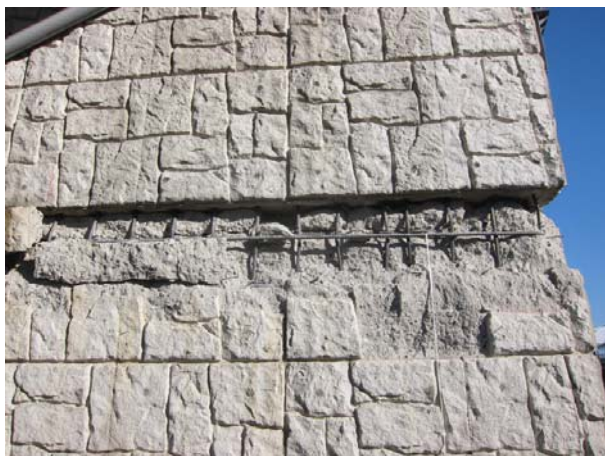
図 1.2 胸壁損傷詳細
