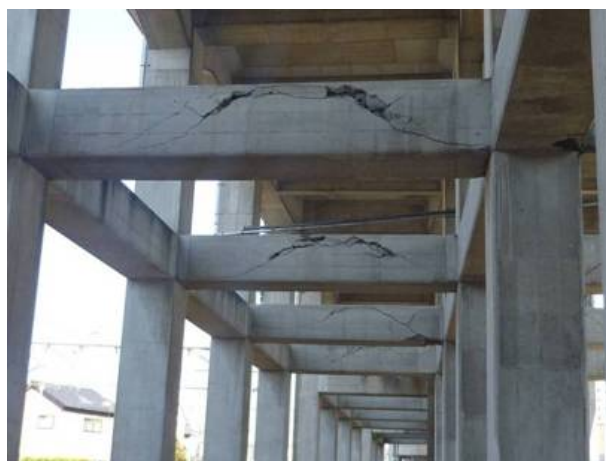
図 1 R1 ブロックの損傷状況（JR 東日本提供）
