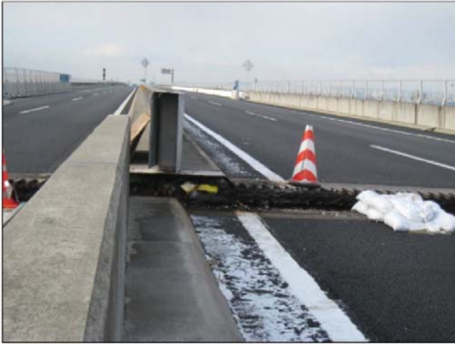
図 14 フィンガージョイントの段差 (P56 橋脚)
