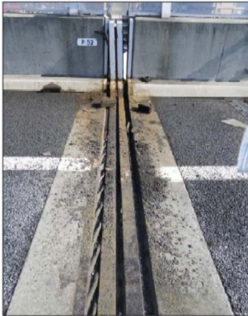
図5 伸縮装置の破損 (P52 橋脚)
