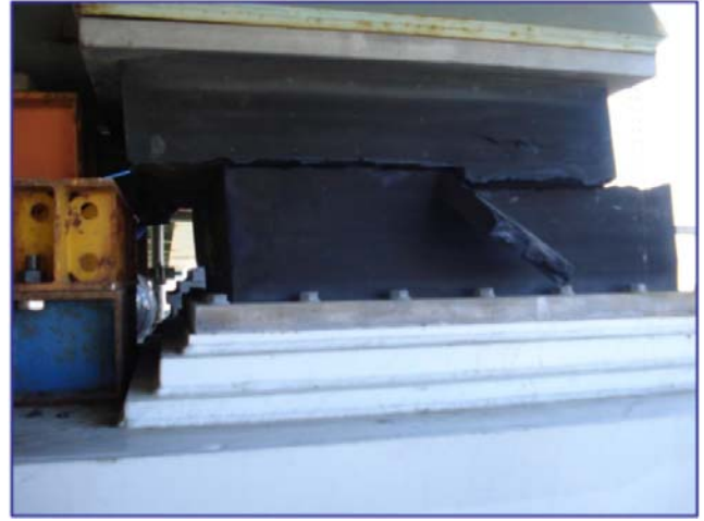
図4 ゴム支承の破断 (P52 橋脚)
