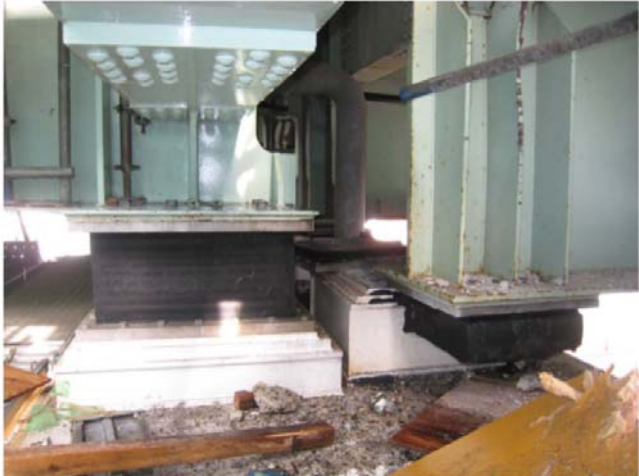
図11 ゴム支承の破断 (P56橋脚)
