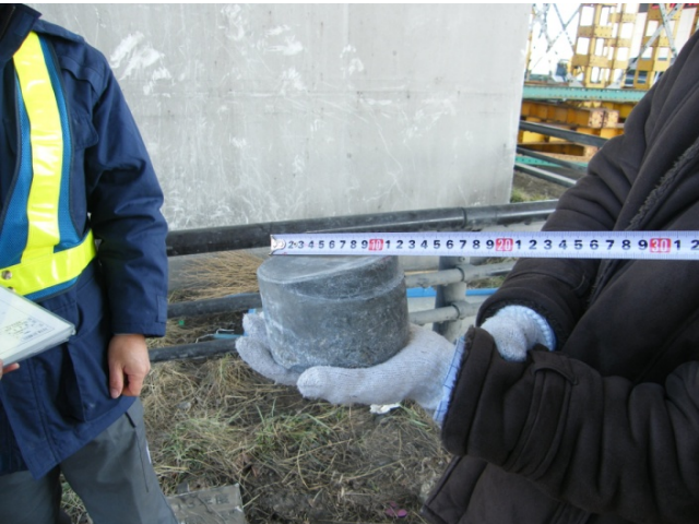
図12 せん断キーの変形 (P56橋脚)
