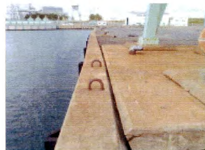
3. 岸壁法線湾曲状況
