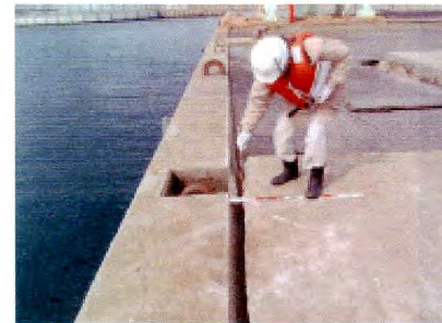
8. 岸壁・ジンボークレーン基礎隙間(約11cm)
