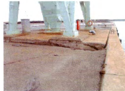
7. ジブクレーン基礎周辺沈下状況
