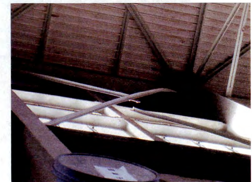
ブレース変形(発電設備)
