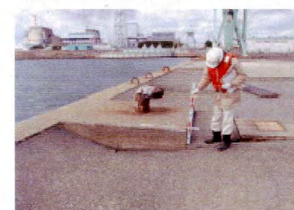
5. 係船柱周辺沈下状況(約30cm)
