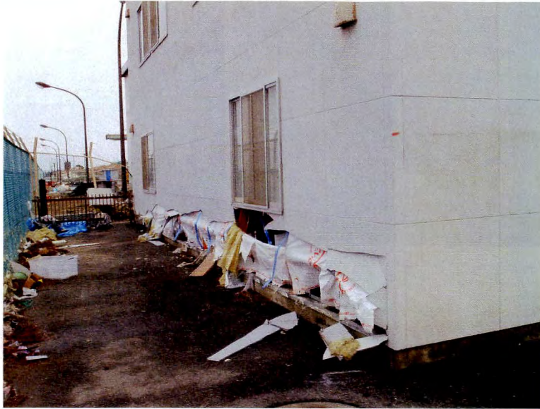
輸送本部建屋（S造）津波による外装材破損
