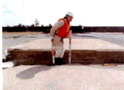
6. ジンボークレーン基礎周辺沈下状況(約40cm)
