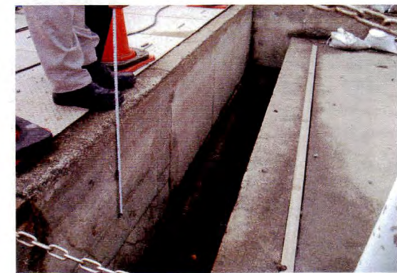
写真⑤ 液状化(地盤沈下)
