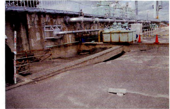
写真① 液状化(地盤沈下)
