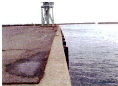
2. 岸壁法線湾曲状況
