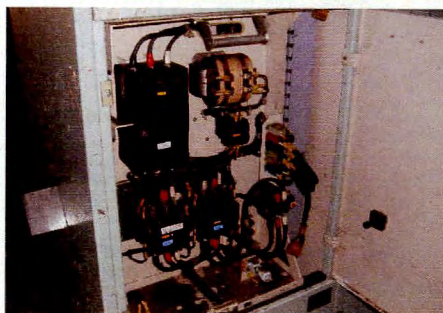
MCCユニット内部
