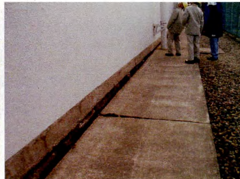
構造物周りの沈下(発電設備)
