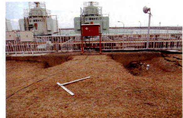
写真② 地盤沈下
