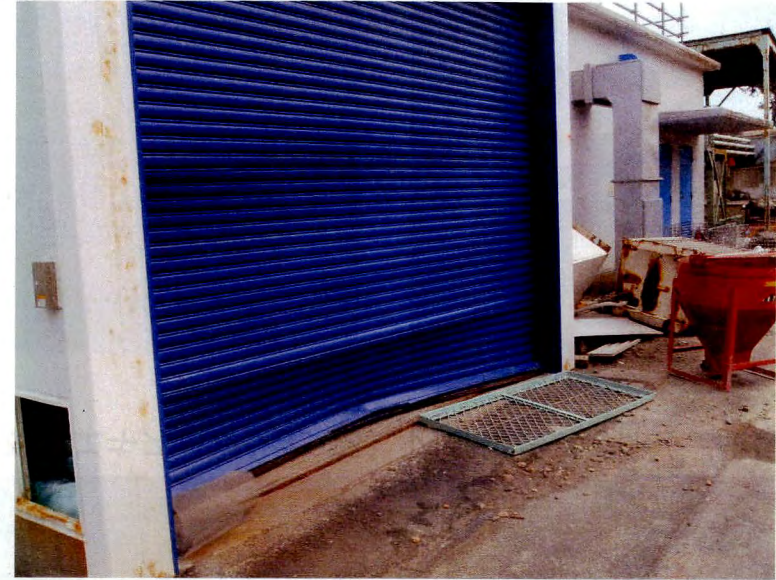
メンテナンスセンター（S造）シャッター変形
