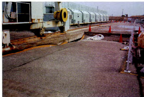
写真④ 液状化(地盤沈下)
