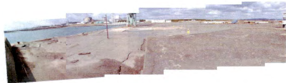
1. 物揚場被災状況全景
