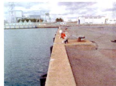
4. 岸壁法線湾曲状況(目視最大約50cm)
