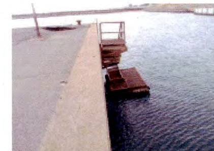
9. 小型船用ポンツーン破損
