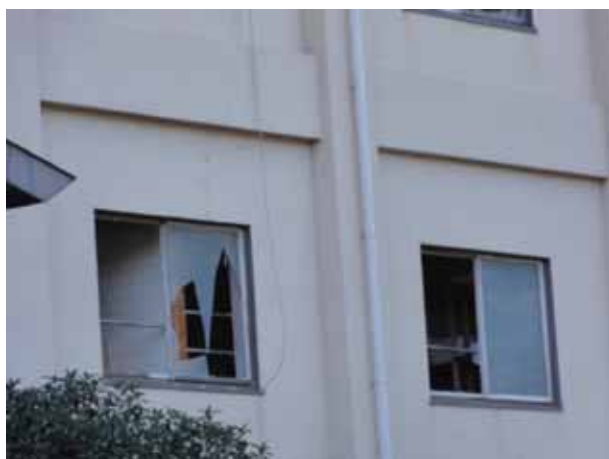
図 2.1.2.2 空振によって破損したホテルの窓ガラス。 霧島市。新燃岳火口から約 5km。
