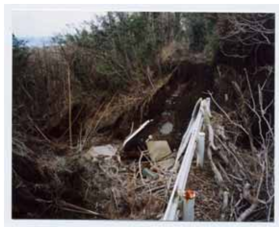
図 3.3.3.2 環状林道の泥流による路盤流失被害
