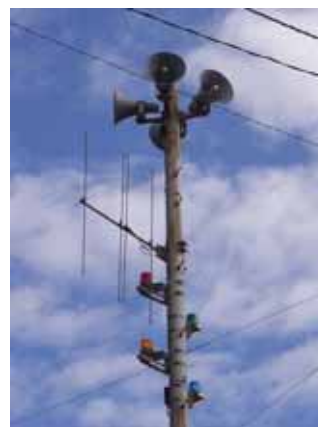
図 6.3.2.8 パトランプ付き屋外子局設置 屋外拡声器とともに火山ガスの発生や濃度を周知する多色のパトランプ
