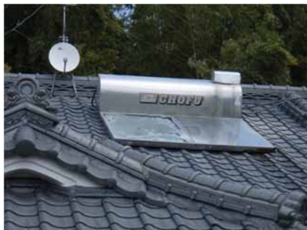
図 2.1.2.1 噴石によって破損した太陽熱温水器 高原町に降下した小さな噴石(火山れき)によって破損した 太陽熱温水器。新燃岳火口から約9 km。周辺には直径1.5～2 cm 程度の火山れきが多数確認された。
