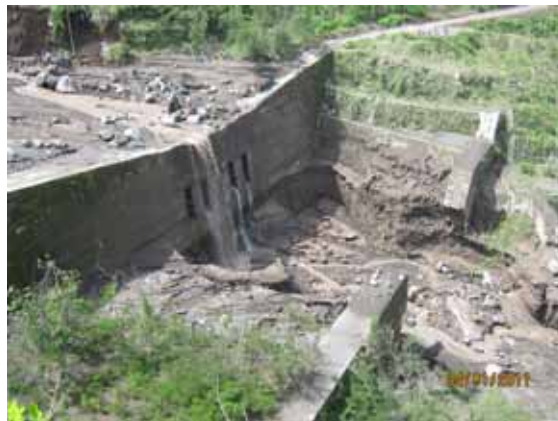
図 3.7.2.3 損傷した砂防堰堤（Apu 川 AP-D3）
