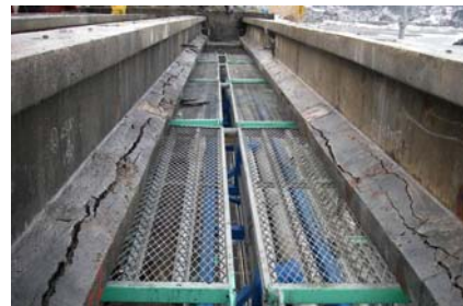
(b) 劣化状況
