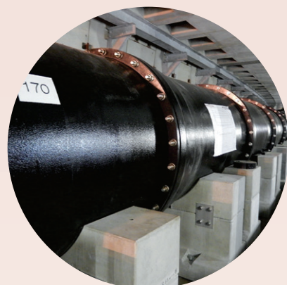
御堂筋共同溝内に設置された水道管路
