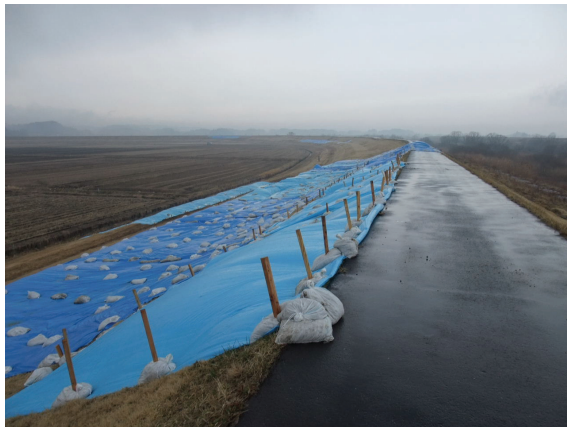
写真7-10 吉田川16.8kmの被災状況
