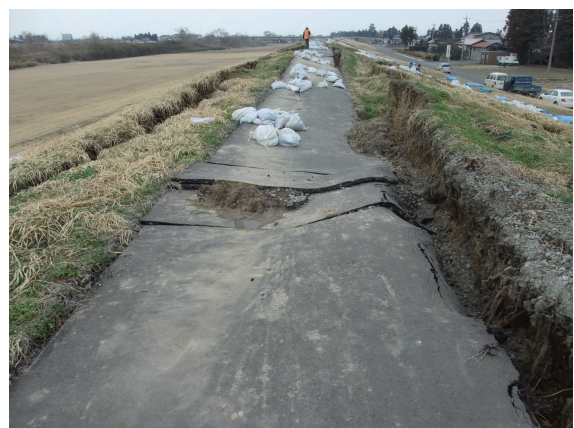
写真 7-5 江合川左岸 21km～21.2km の被災状況
