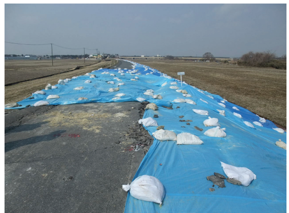
写真 7-4 江合川 30.2km の被災状況
