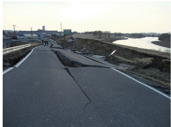
写真 7-3 志田橋右岸取付け盛土の被害
