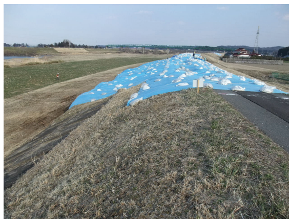
写真 7-2 鳴瀬川左岸 40.06km の被害
