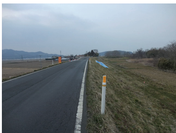
写真 7-8 江合川右岸 19.9km の堤防天 端沈下状況
